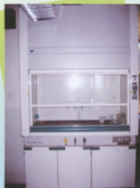
抽風煙廚外貌
